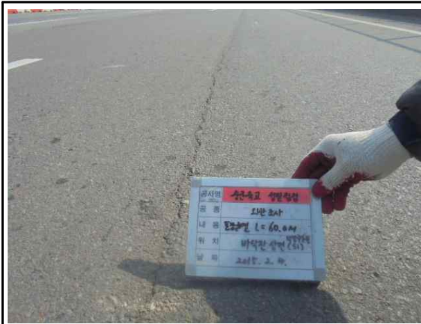
S1 교면포장 균열
