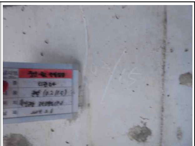
P1 교각 c/w=0.2mm 균열
