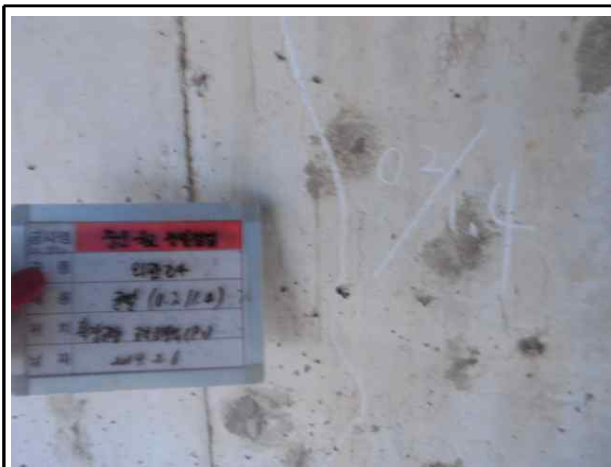
P1 교각 c/w=0.2mm 균열
