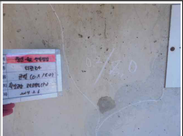
P1 교각 c/w=0.2mm 균열
