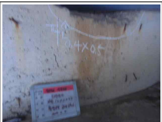
A2 교대 파손
