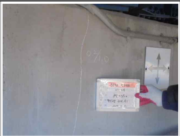
A1 교대 c/w=0.2\text{mm} 균열
