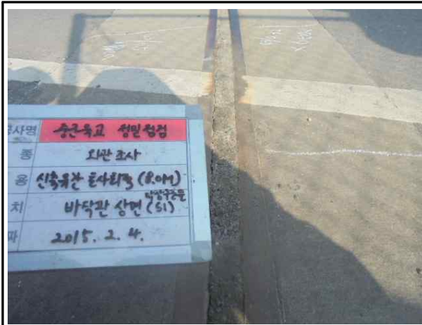
A1 Rail Joint 신축유간 토사퇴적
