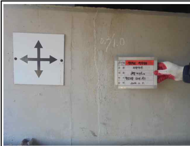
A1 교대 c/w=0.2\text{mm} 균열
