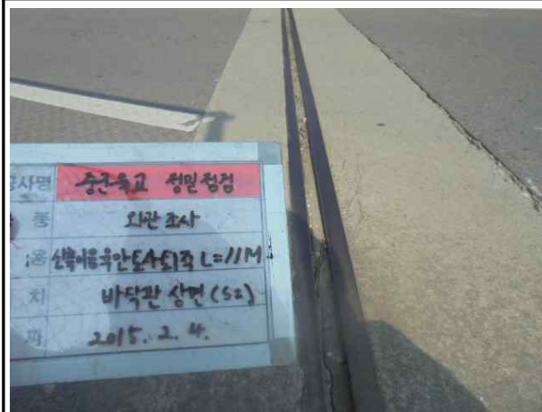
A2 Rail Joint 신축유간 토사퇴적
