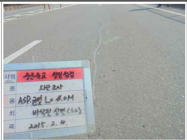
S2 교면포장 균열
