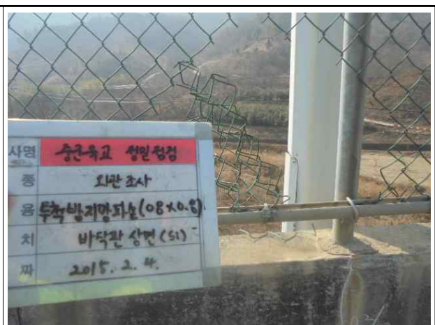
방호벽 S1 투척방지망 파손
