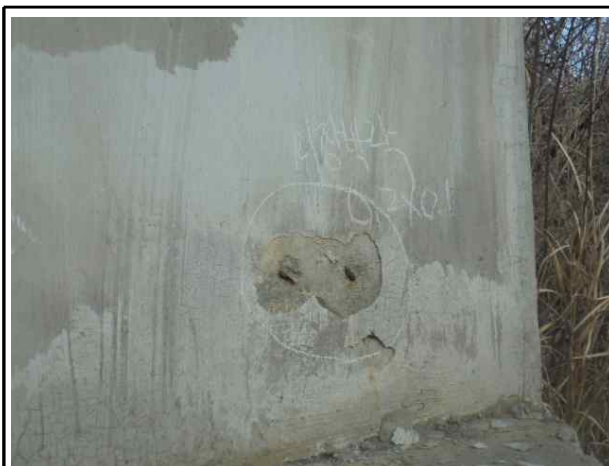
A2 교대 파손
