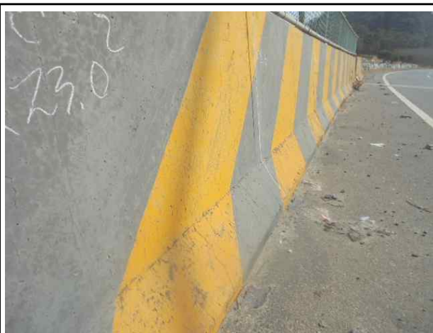
방호벽 S2 망상균열
