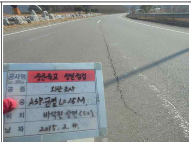
접속도로 A2 교면포장 균열
