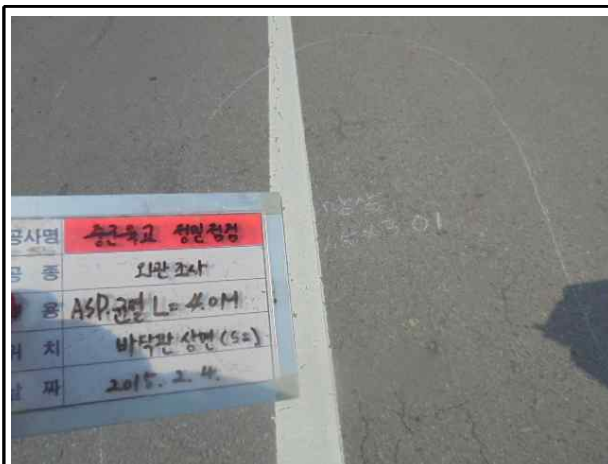
S2 교면포장 망상균열
